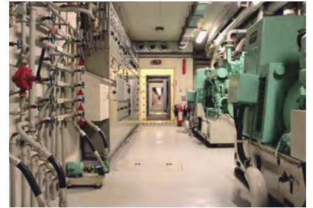
9. Maskinrum med nødgenerators. Foto: Karsten Pedersen.
