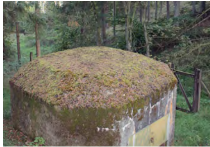
8. Et af de to udstødningstårne til nødgeneratorene. Foto: Karsten Pedersen.
